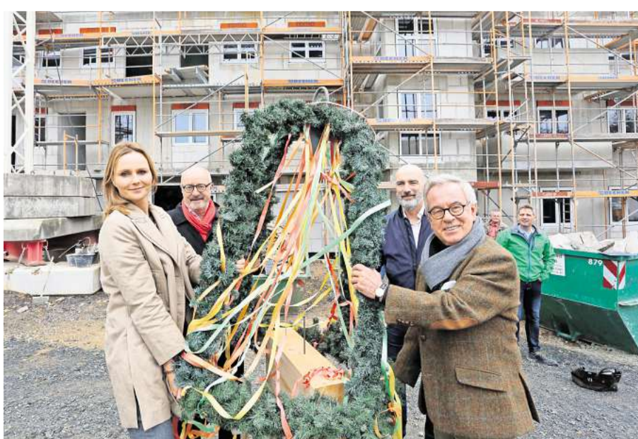
Fertigstellung bis Mai: Am Richtkranz des Gesundheitszentrums Zwenkau stehen (v.l.) Nancy Bolmerg, Reinhard Steinbruch, Klaus Bolmerg und Frank Schmidt. Foto: A. Kempner
